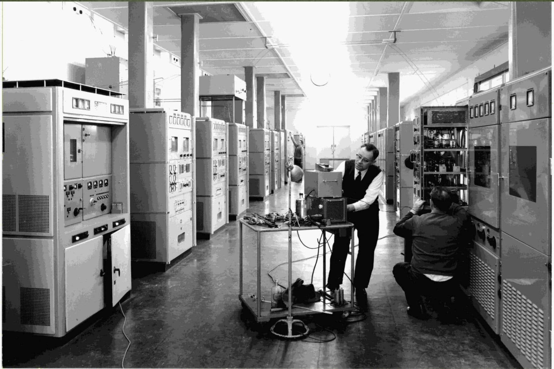
Zenderzaal zendgebouw D radio-zendstation Kootwijk. Transmitterroom building D radio-transmitterstation Kootwijk.
